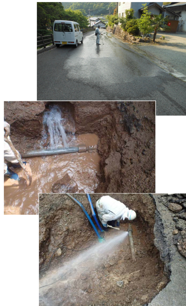
図 当企業団の漏水事故の様子
