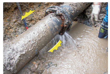
老朽化した水道管
